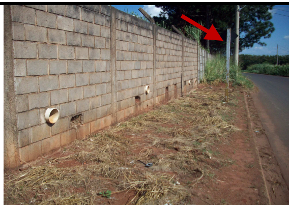
Figura 12 - Calçada Irregular I.
